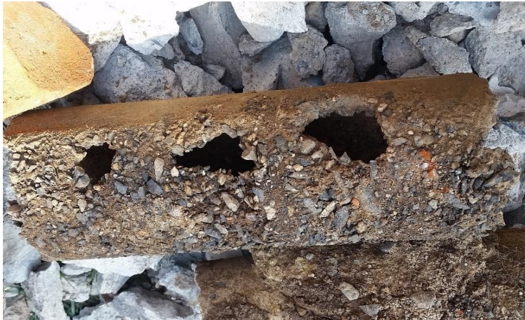
Tubería de desagüe, utilizada en los años 70, retirada de casa en remodelación iniciada el año 2018
