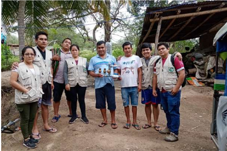
Figura 12. Instalación de bomba de ariete caserío Las juntas-Bagua-Amazonas Fuente: Elaboración propia
