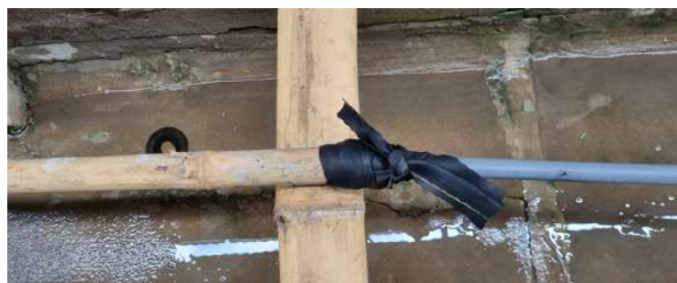
Figura 5. Acoples entre bambú y tuberías convencionales Fuente: Elaboración propia
